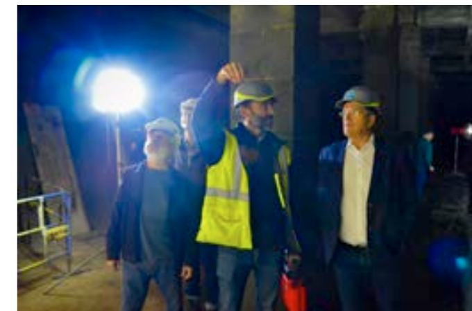
Une visite de chantier a été organisée pour la presse et les élus le 16 novembre
