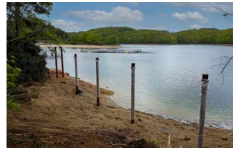
Sur le Couderc d'abrat, les pylônes de la passerelle ont été posés
